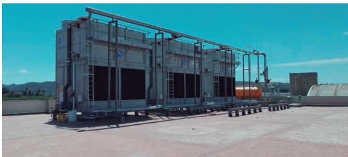
Vista de los nuevos condensadores evaporativos.
